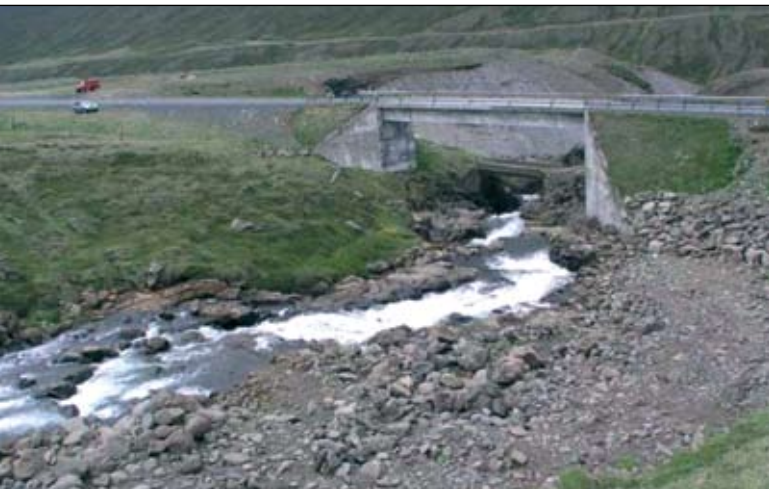
Tvær brýr á Ystu Rjúkandi. Sú eldri er frá 1928 og á að varðveita hana. Sú yngri verður rifin.
